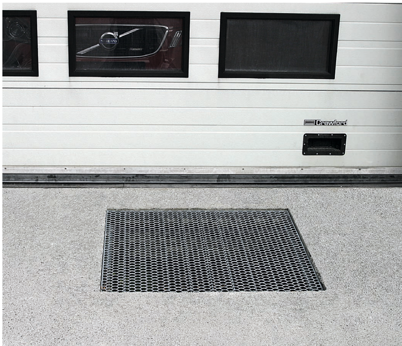
Kjøreforsterket rist foran garasje (bilforretning).
